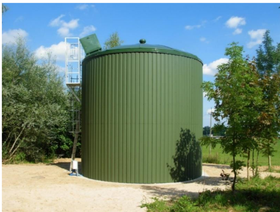
Rysunek 1. Widok zbiornika retencyjnego wody czystej
